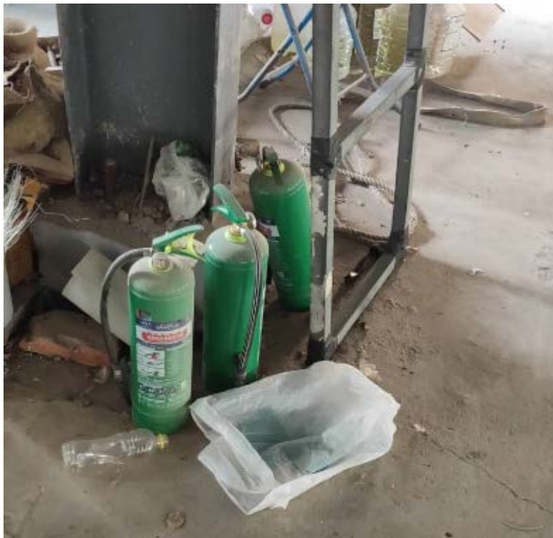
图 3-7 车间配备水基型灭火器
