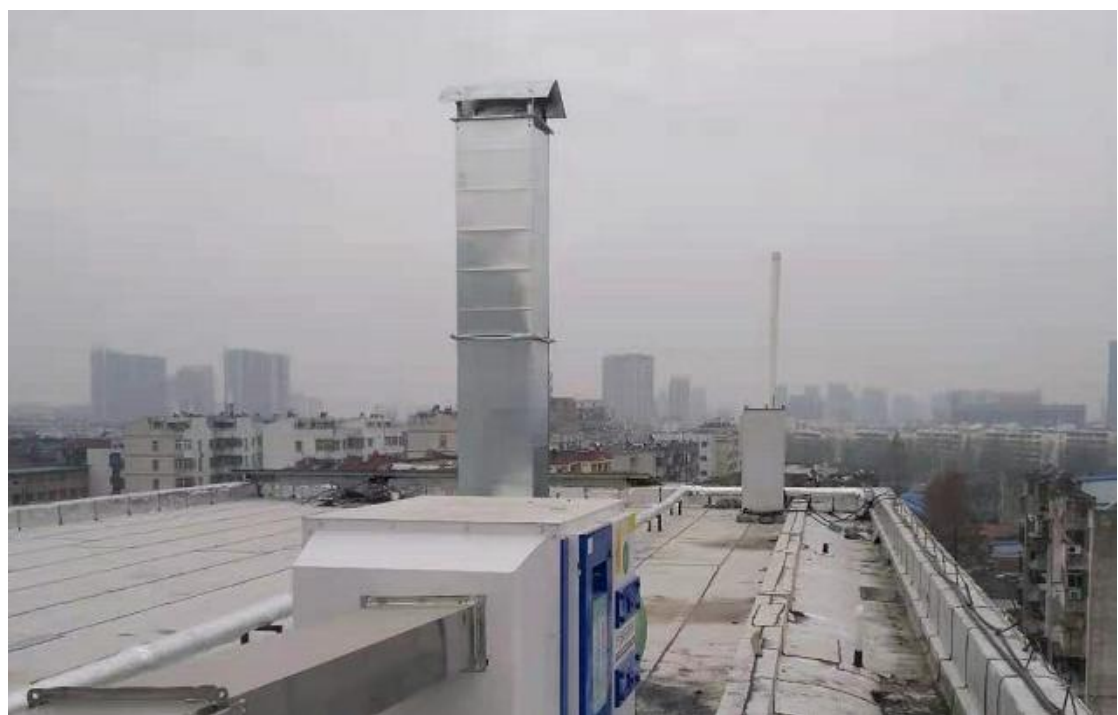
图 3-4 化验室废气处理设备
