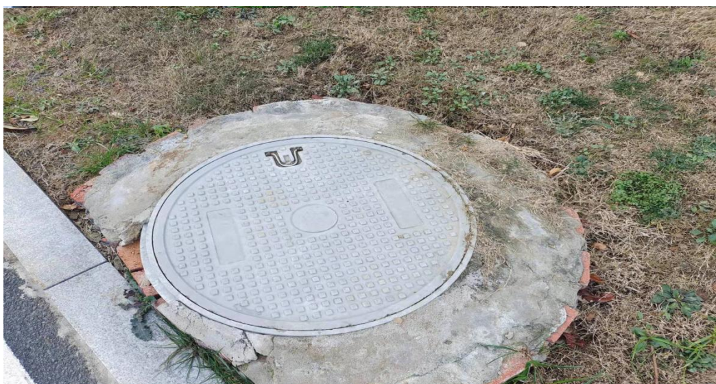
图 4.1-1 场区废水收集池、化粪池
